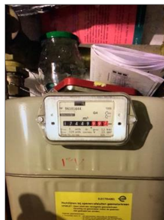
Compteur de gaz
